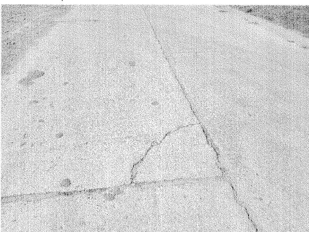
Ruptura de colt a dalei
