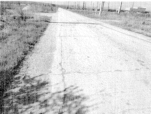
Fisura pe margine si fisuri transversale
